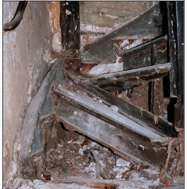
Abb. 4: Treppeneinbruch durch einen Hausschwamm-Befall.
