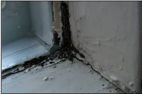
Abb. 1: Kleine Fruchtkörper von Bläue- und Schimmelpilzen an einem Fenster (Glasanschluss). Die Sporen quellen bei Befeuchtung aus offenen Fugen (aus HUCKFELDT 2008).
