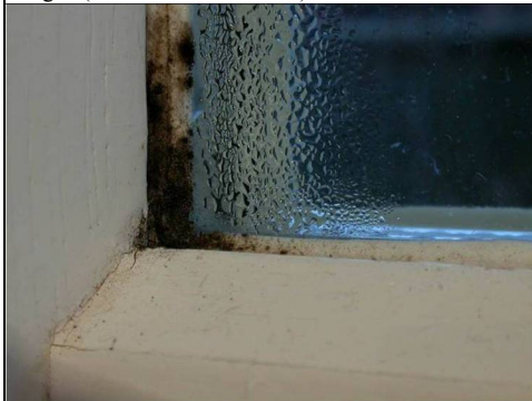
Abb. 2: Schimmelpilzbefall an der Dichtungsmasse; Kondensat-Tropfen an der Scheibe im Anschluss zum Rahmen weisen auf eine oft erhöhte Feuchte hin.
