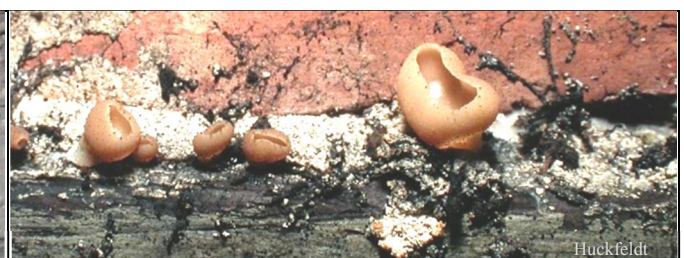
Abb. 3: Fruchtkörper eines Becherlings oberhalb eines Fachwerk-Riegels, Braunfäule-Schaden durch Kellerschwamm ( Coniophora sp.) in der Nähe.
