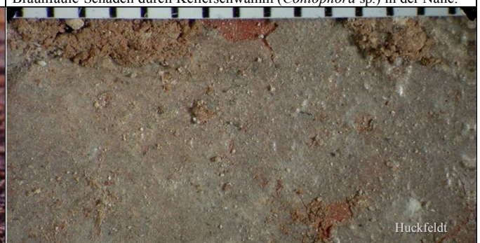
Abb. 5: Dünnes weißes, durchscheinendes Mycel eines Becherlings an feuchtem Mauerwerk; Maßstab mit Millimeterskala (oben).
